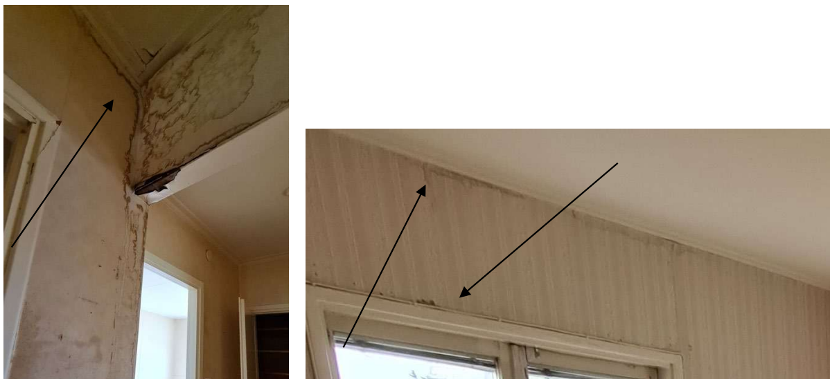
Bild 11 Noterade fuktanvisningar i lägenhet på våning två.
