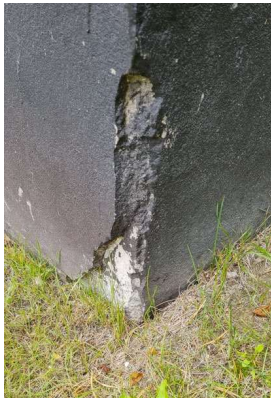
Bild 6 Sockel, bortfall av material i putsning
